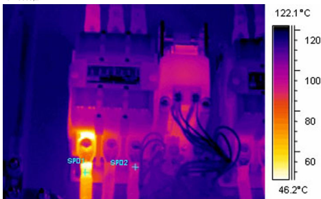
Figura 16.9 Immagine termica dell'impianto elettrico interno (2)
