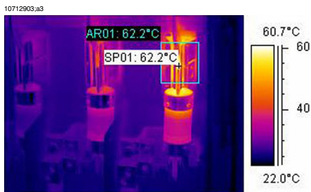
Figura 16.3 Immagine termica di una scatola di fusibili in cui viene visualizzata la temperatura massima
