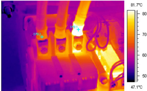
Figura 16.8 Immagine termica dell'impianto elettrico interno (1)
