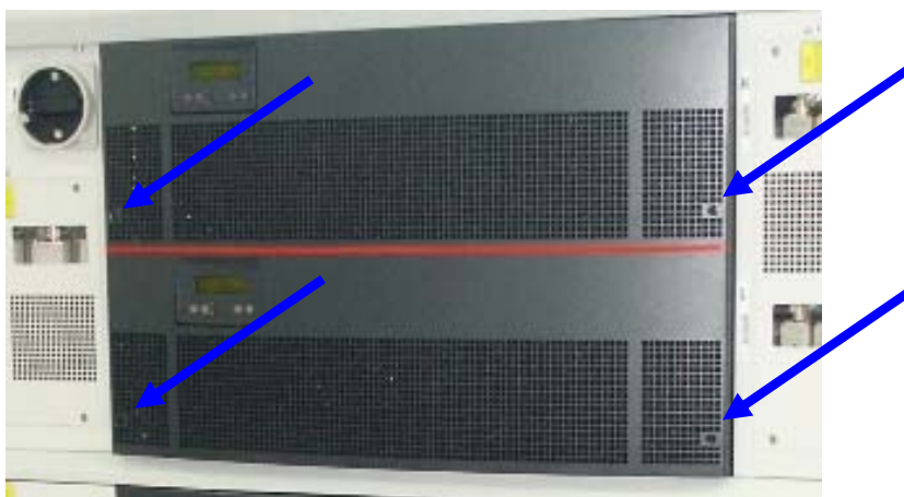
Figura 15-1 : Viti sul pannello “Zona Moduli”
