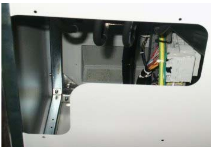
Figura 11-3 : Apertura passaggio cavi DC tra Framework – vista da sotto.
