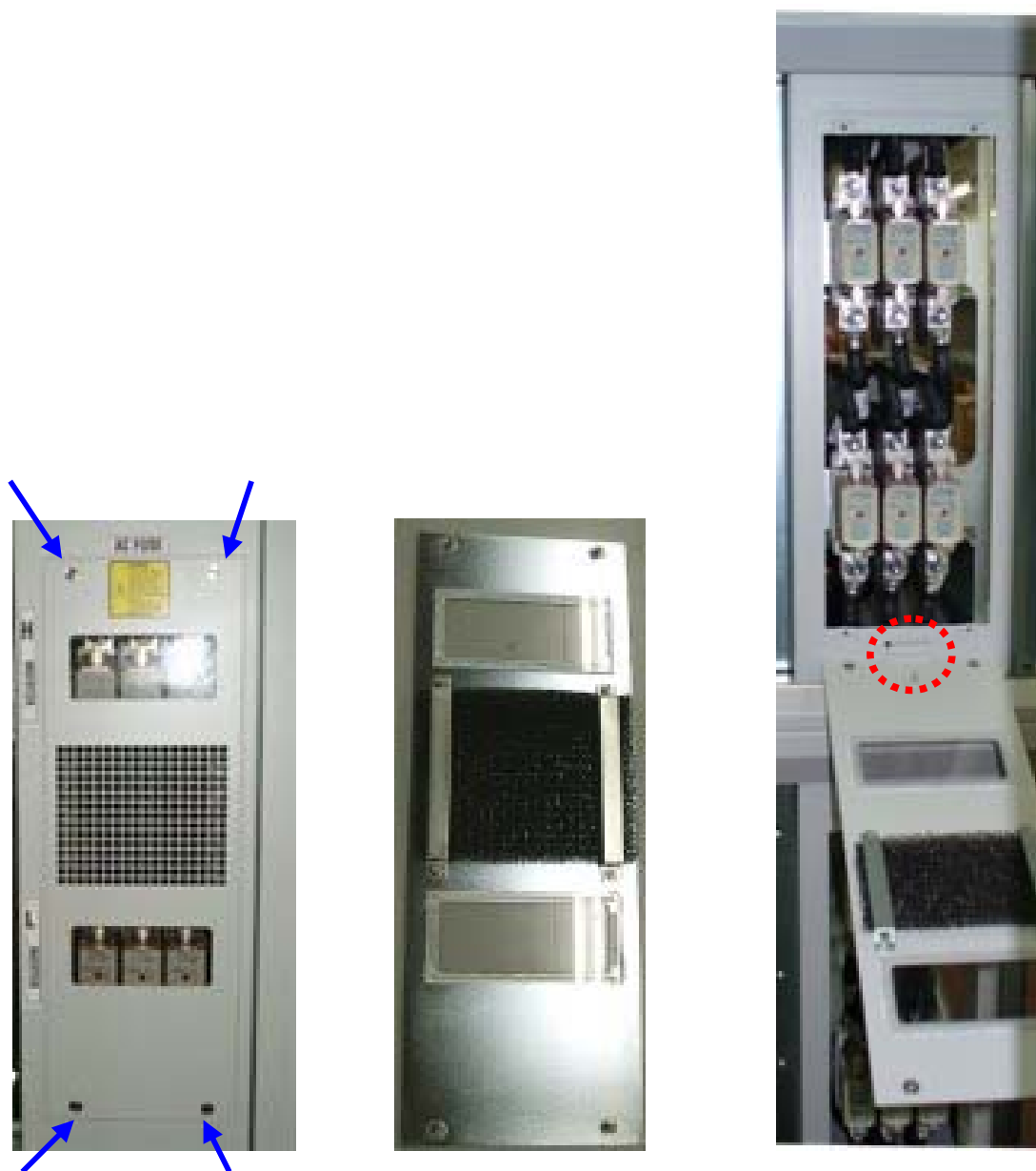
Figura 15-6- Filtro “Zona fusibili AC” (esterno ed interno del pannello)
