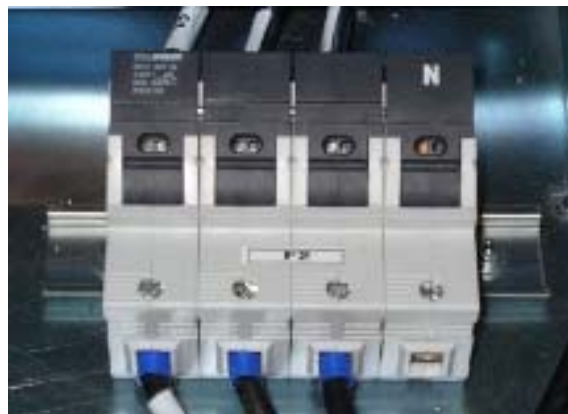
Figura 15-10- Portafusibili F2 per protezione OVR AC
